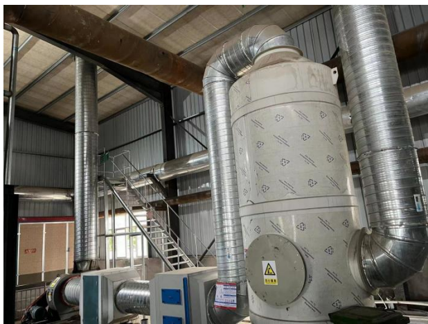
喷淋塔+活性炭吸附装置
